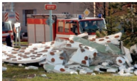
Destrukce celého systému VKZS, následek nesoudržného podkladu vlivem nedostatečného lepení a kotvení. Nedodržování certifikované technologie. Neodborné využívání UV 11163 se vzduchovými mezerami.
