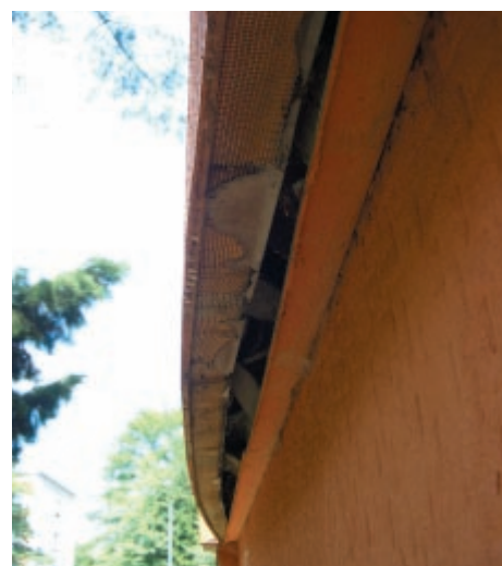
Uvolnění izolačního souvrství VKZS v důsledku nesnovaného podkladu a zavlhnutí izolační vrstvy.
